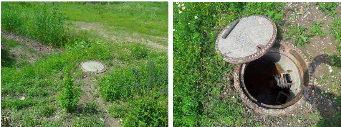
Abb.: Endschacht mit „Auslauf“ Entlastungsdrainage M24, südlich des Plangebietes
